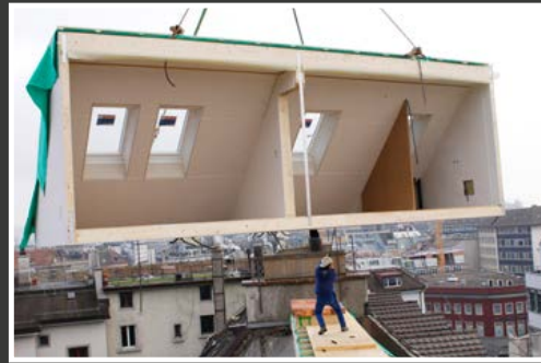
Montage vor Ort
